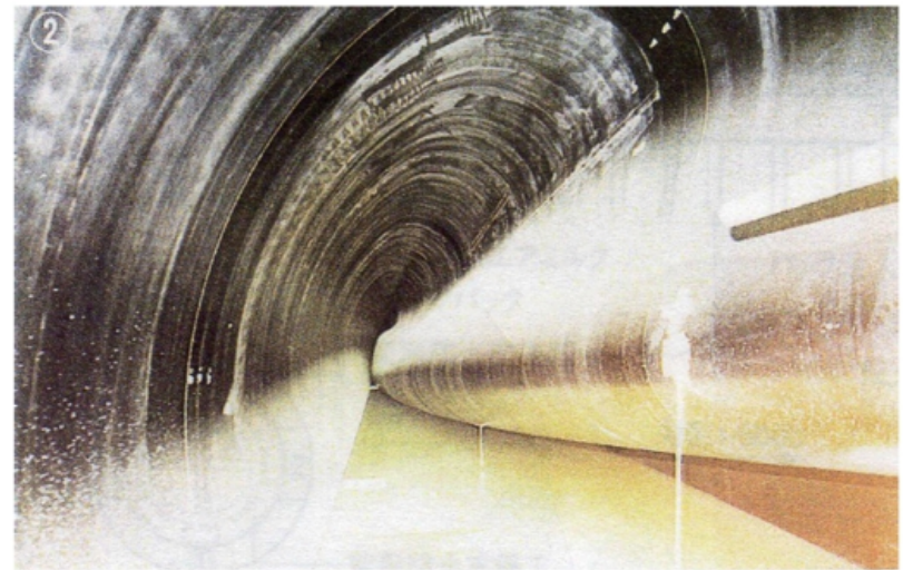
Fig.2 変形した鋼管の内部（日経コンストラクション，1999） Inside the bended steel pipe
